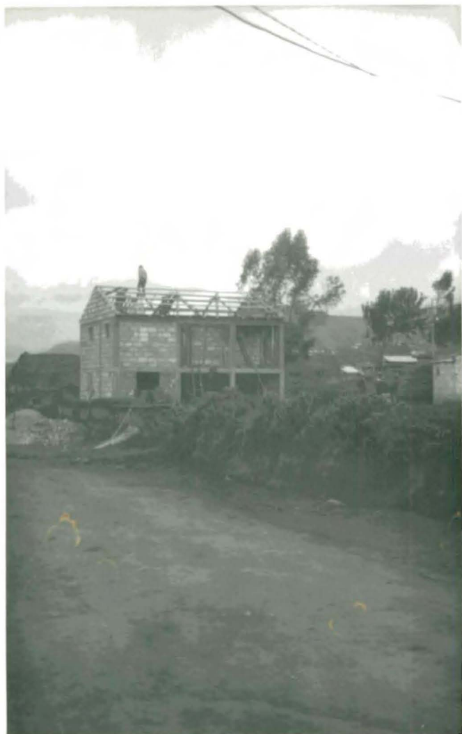
Preparando el techamiento de una vivienda. (sector de Pila-huín Centro, Comunidad de Pucara Grande)
