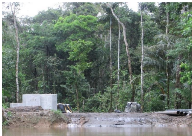
Figura 4.15. Desembarque de materiales en Yanayaku, riberas del río Tiputini, con destino al pozo Tiputini C, bloque 43.
