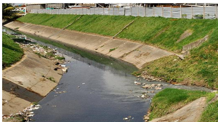
Figura 18. Estado de uno de los canales de agua lluvia en Cali
