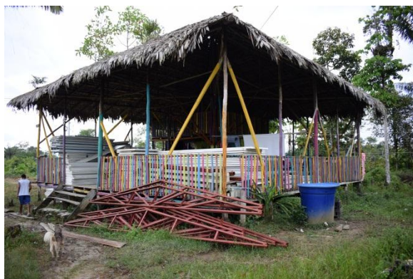
Foto 7. Estado de la Casa de la Cultura ubicada en La Loma. Fuente: fotografía de Christian Santacruz (La Barra, agosto 2020)
