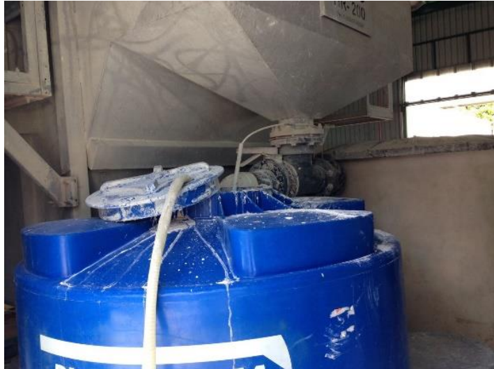
Fotografía 10. Tanque de lodo para dewatering y adición de cal. Fuente: Fotografía tomada del trabajo de campo 2017
