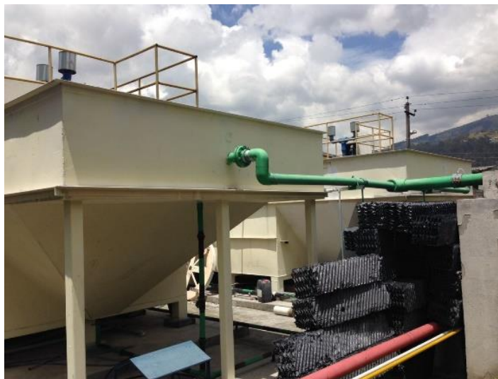
Fotografía 7. Vista externa de los biodigestores. Fuente: Fotografía tomada del trabajo de campo 2017
