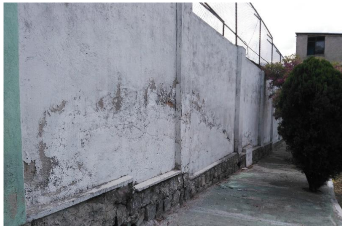
Fotografía 21. Pared posterior central con humedad. Fuente: Fotografía tomada del trabajo de campo 2017
