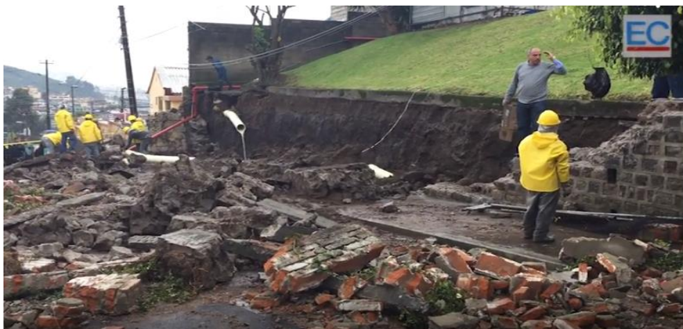
Fotografía 18. Derrumbamiento del muro de PQSA, enero 2016 #3. Fuente: Dario El Comercio 2016
