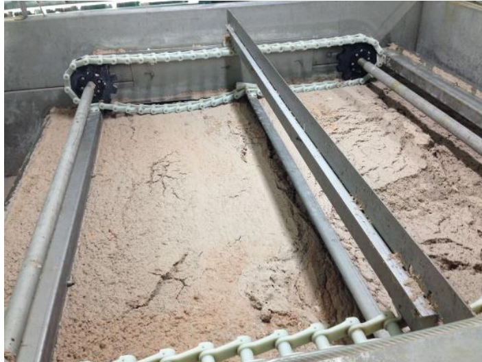
Fotografía 6. Lodos formados en el DAF Fuente: Fotografía tomada del trabajo de campo 2017
