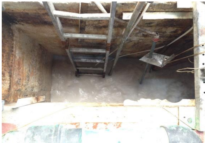
Fotografía 2. Tanque homogeneizador. Fuente: Fotografía tomada del trabajo de campo 2017
