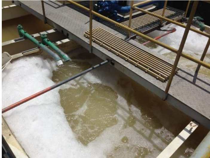
Fotografía 8. Vista interna de los biodigestores. Fuente: Fotografía tomada del trabajo de campo 2017
