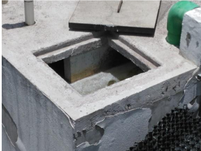
Fotografía 15. Tanque de cloración vista interna. Fuente: Fotografía tomada del trabajo de campo 2017
