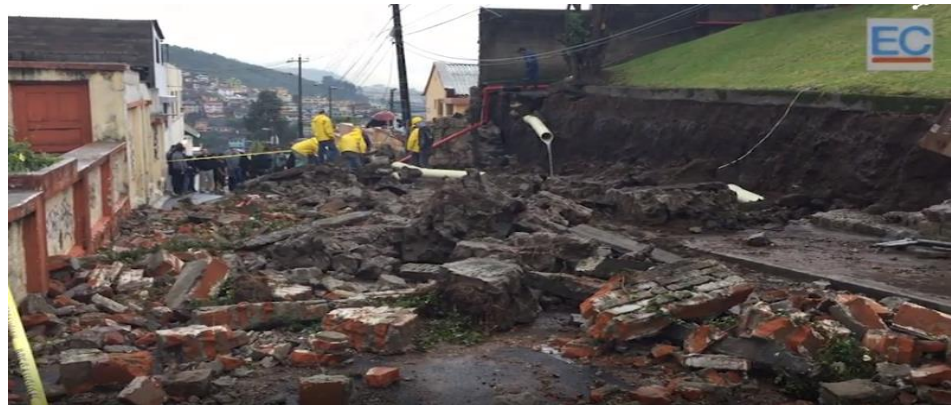
Fotografía 17. Derrumbamiento del muro en PQSA, enero 2016 #2 Fuente: Diario El Comercio 2016
