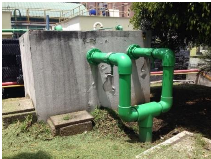
Fotografía 14. Tanque de cloración vista externa. Fuente: Fotografía tomada del trabajo de campo 2017
