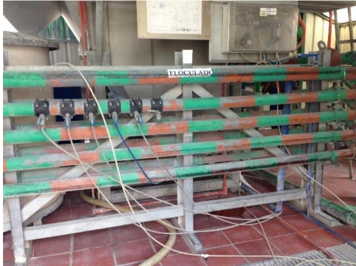
Fotografía 4. Floculador, inyección de coagulante y floculante. Fuente: Fotografía tomada del trabajo de campo 2017
