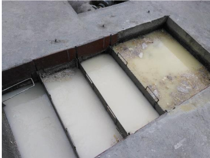
Fotografía 1. Punto de entrada del agua cruda. Fuente: Fotografía tomada del trabajo de campo 2017
