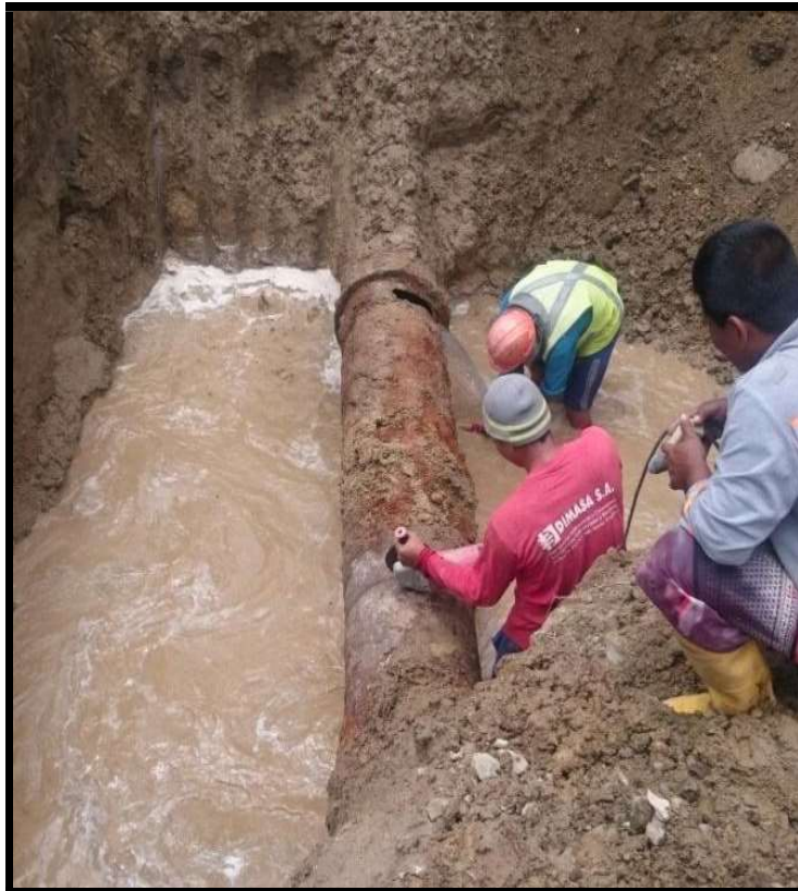
Foto 2.6 Daños en el acueducto Santa Martha
