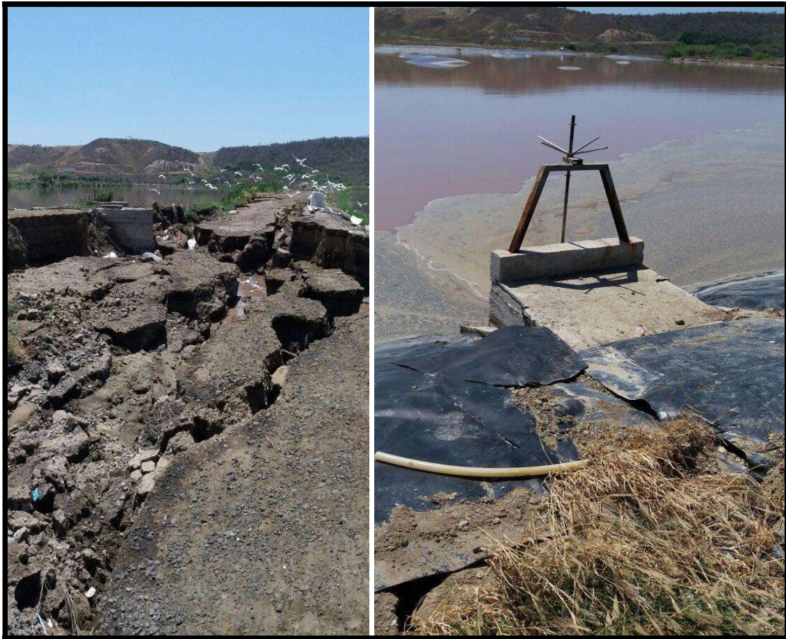
Foto 2.8 Daños en piscinas de estabilización
