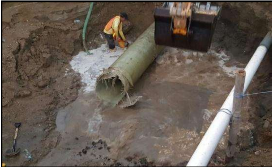
Foto 2.7 Daño en el acueducto Colorado - Santa Marta
