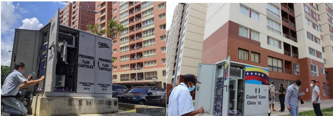
Casetas de servicio de telefonía residencial e internet de cada Sector.
