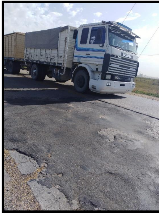
Figura 27: Camión en contramano debido al estado de los accesos del Puerto de Bahía Blanca
