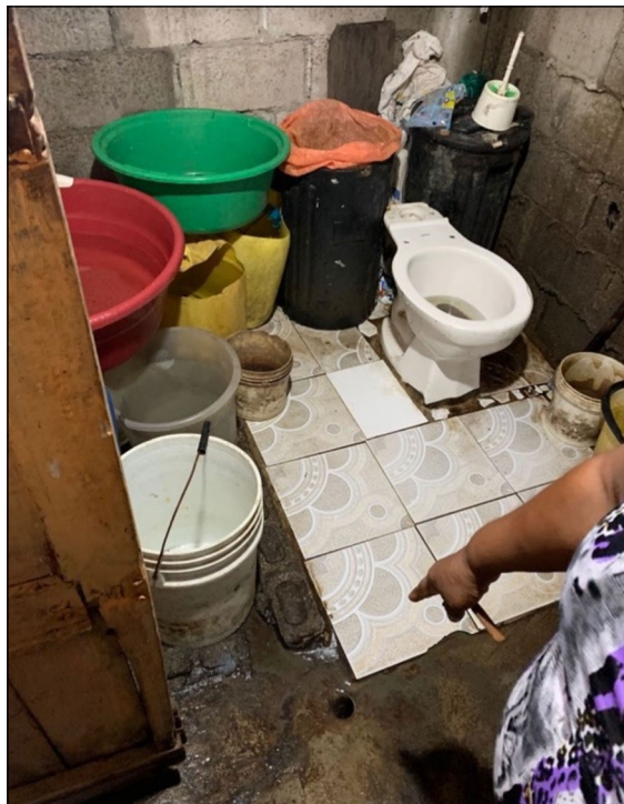
Figura 5.1. Fotografía de visita a hogares: tipo de instalación sanitaria
