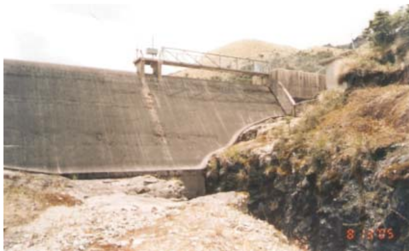
Fotografía No. 4.10 Represa Parcacocha, ECOLUZ S.A.
