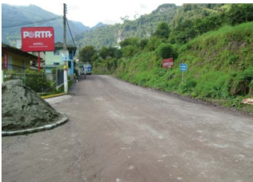
Fotografía No. 3.17 Estado de la carretera
