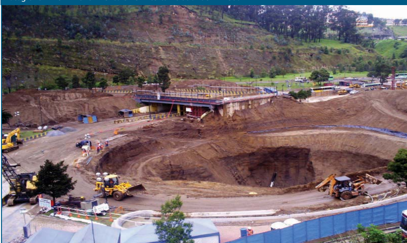
Fotografía N.º 5.2 Hundimiento en el intercambiador de El Trébol
