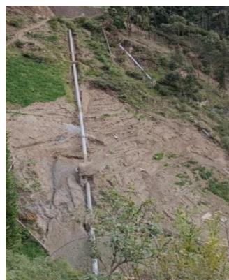
Fotografía 4.3. Restauración provisional del sifón 2
