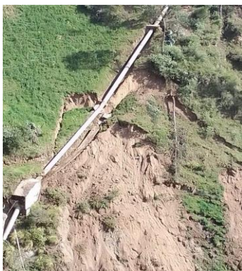
Fotografía 4.2. Daños en la infraestructura del sifón 2
