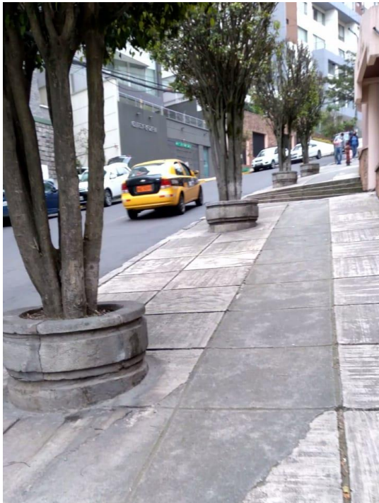
Foto 6.4. Estado de las aceras en la zona baja de Bellavista
