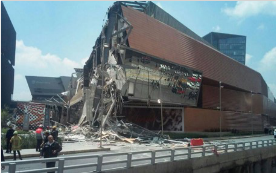
Figura 6. Derrumbe parcial de la fachada de la Plaza Artz
