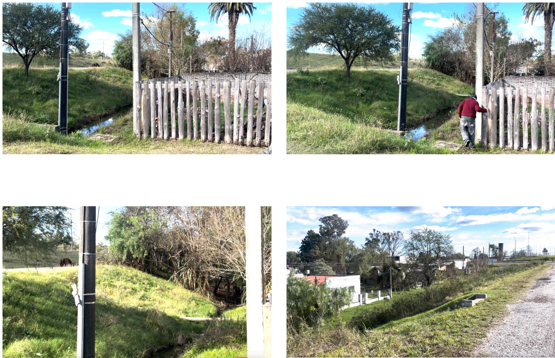
Figura 21 y 22: Avenida de las Américas y Raul Celone. Predio de la antigua propiedad de Raúl Celone (casa y comercio). Se observa la cuneta de la antigua calle, el hundimiento en que se encuentran algunas viviendas, y la inexistencia de espacio peatonal que permita el acceso a las viviendas y la movilidad entre casas vecinas. Figura 23: Cuneta y acceso mediante puente. Figura 24: Terraplén que hay que bajar para ingresar a las casas ubicadas sobre Avenida de las Américas. Fuente: Fotogramas de audiovisual producido al “Caminar con la cámara”. Elaboración propia.
