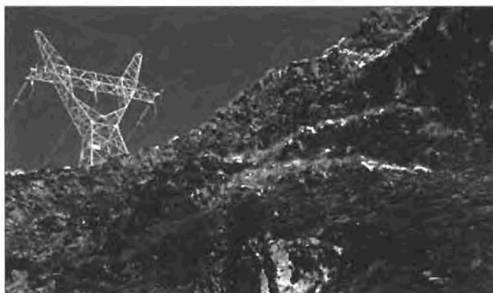
Líneas de transmisión Isa-Bolivia. US$ 23.0 MM
