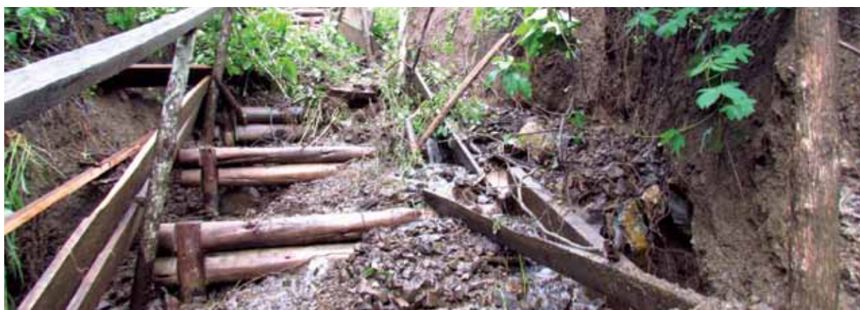
Daños escaleras Isla De La Plata
