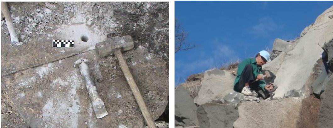
Fotografía 12 A la izquierda barrenado en la localidad de El Tlacuache; a la derecha barrenado en la localidad de Japacurío.
