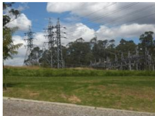
Subestación de Energía de la EEQ
