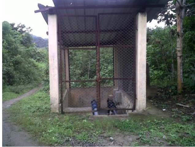
Foto 28. Estación de captación y bombeo ubicada cerca del río Ayampe Fuente: Paola Valenzuela. Septiembre, 2010.
