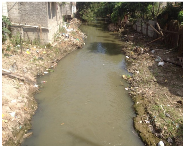
Fotografía 3. 11. Poco caudal de aguas debido a la construcción de la derivación del canal, dificulta el flujo de las aguas servidas
