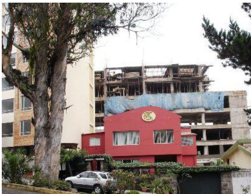
Foto N o 12 – Adriana Luz – final de 2008; rua Whympers Restaurante e residência dos donos. Edifícios passam a rodear as casas ainda existentes transformando a vida dos moradores
