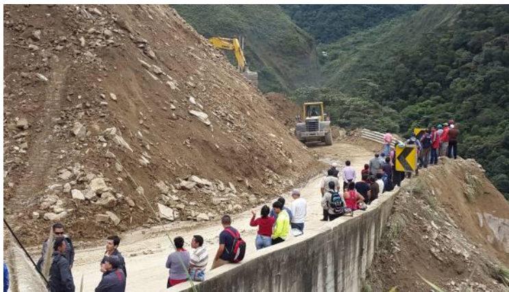
Fotografía 3.3. El deslave en la Transversal Sur, tramo Zamora-Loja
