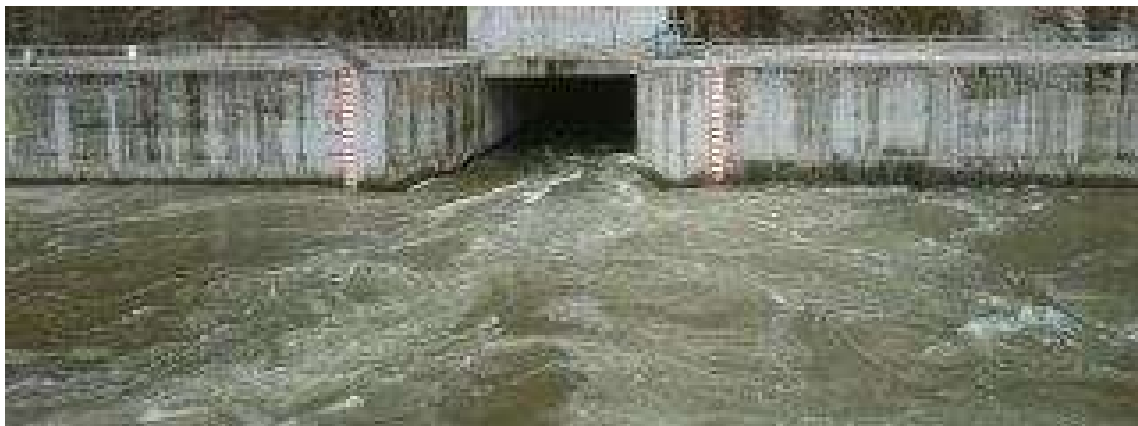
Fotografía 4.1. Ventana de Captación en CCS. Fuente: Trabajo de campo
