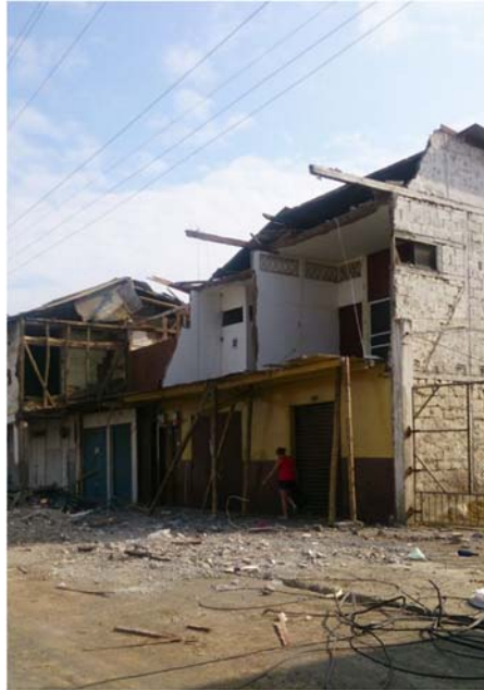
Fotografía 2. Vivienda colapsada en cantón Pedernales. Fuente: Trabajo de campo
