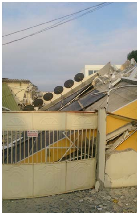
Fotografía 1. Vivienda colapsada en cantón Jama. Fuente: Trabajo de campo
