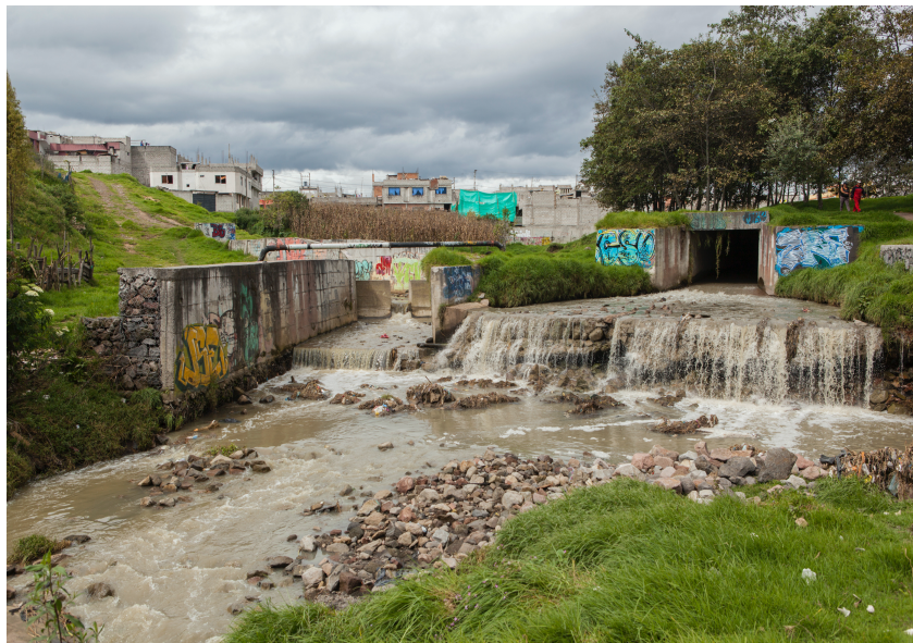
Figura 3.7. Cabeceras del Machángara en Caupicho, aquí se unen colectores de aguas servidas de Caupicho, Bellavista y Santa Gloria. La gente refiere menos agua en las quebradas en el pasado Fuente: trabajo de campo
