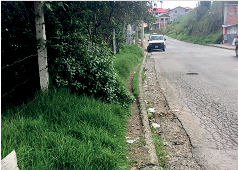
Estado de la infraestructura vial. Fotografía tomada por Paola Ortiz.
