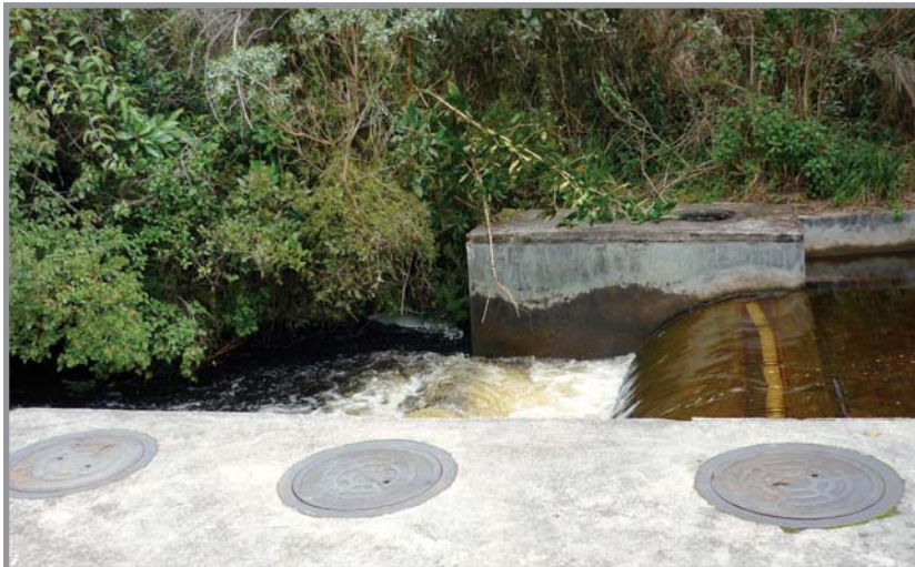
d. Tanques y caída oxigenadora del acueducto comunitario de Valencia.
