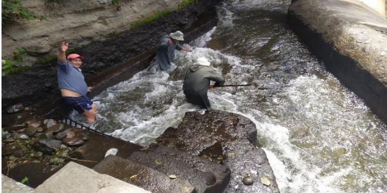
Figura 2.2. Captación de limpieza del canal de riego Pita, Pintag
