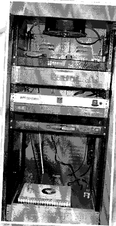
El rack de comunicaciones
