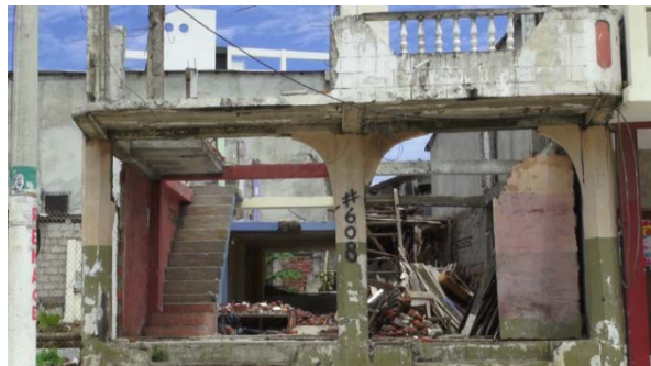
Figura 3.2.1.2. Casa destruida en San Roque Fuente: Nicolás Schwarzberg, fotografía digital, 2016
