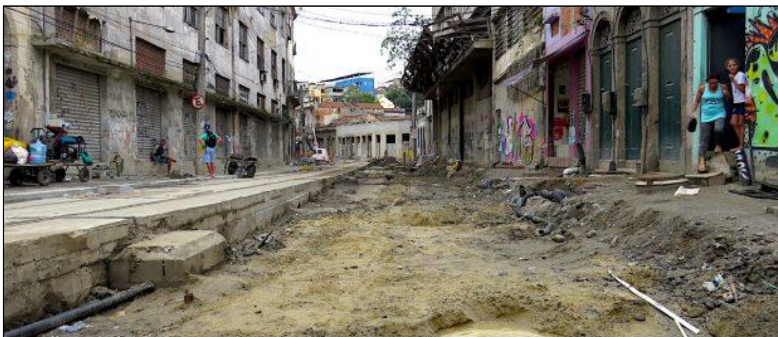
Figura 14 – Obra não concluída na região portuária 96
