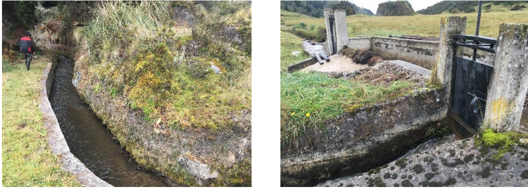
Figura 5.2 y 5.3. Canales de riego abierto en la zona de amortiguamiento del páramo.
