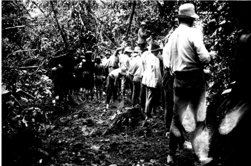
Fotografía 18. Mejoramiento de caminos de herradura al oriente ecuatoriano, 1939. Fuente: Ministerio de Cultura y Patrimonio del Ecuador. Código: F0009.005
