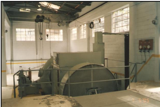
Fotografía No. 4.4 Turbina de Generación ECOLUZ S.A.
