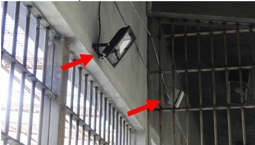
Fotografia 14- Detalhe da lâmpada externa para iluminar as celas e da caixa de som do sistema de comunicação
