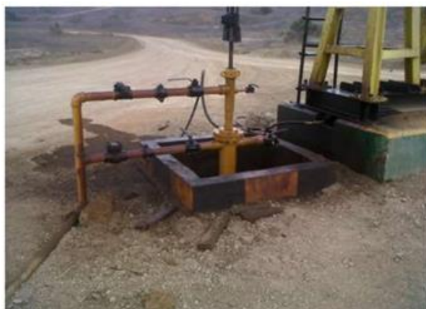
Figura 4. 6. Afectación de la superficie terrestre
