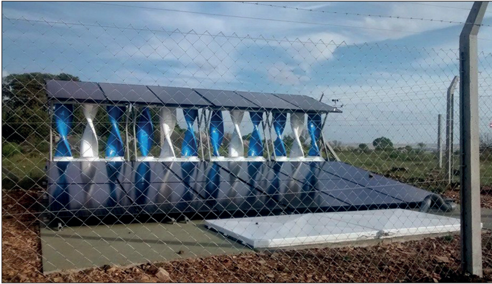
Foto 2. Sistema híbrido eólico-solar en el Cristo de las Sierras, Tandil (Buenos Aires)
