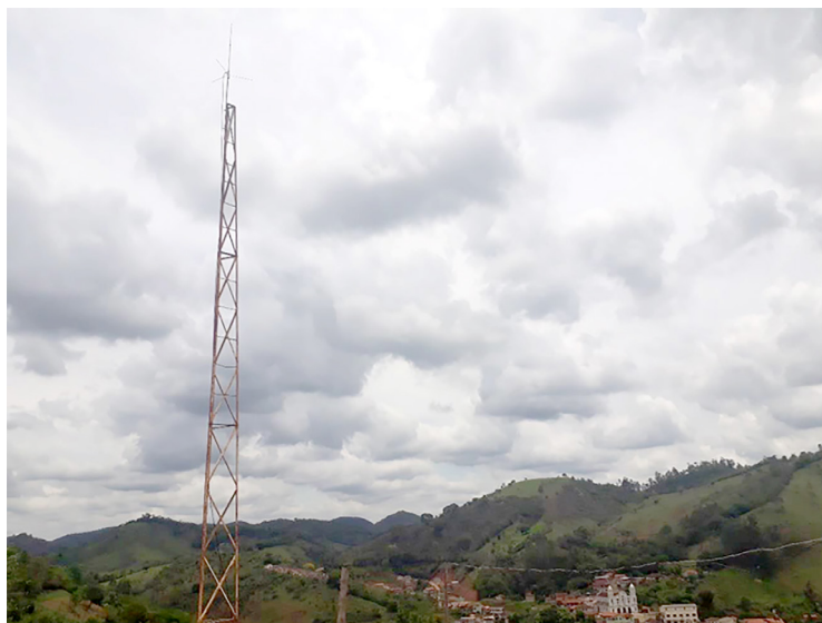
Foto 2 – Torre de transmissão da Rádio Paraíso
