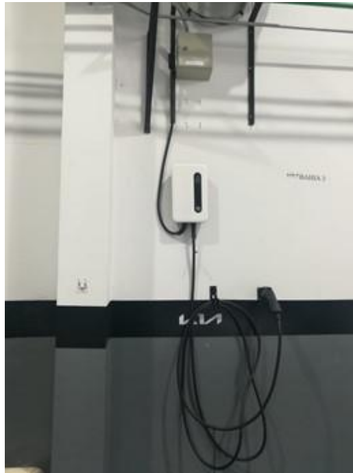
Foto 2.1. Estación de carga de KIA Ibarra
