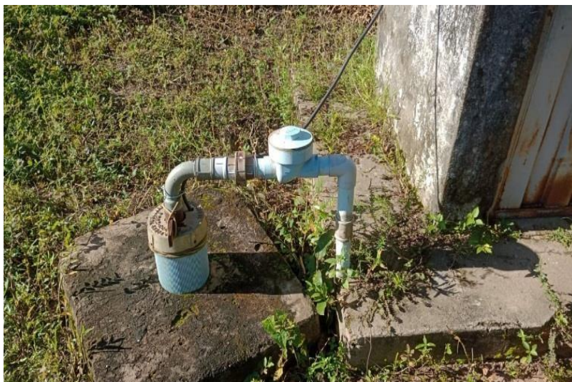
Figura 13 – Poço Tubular do assentamento
