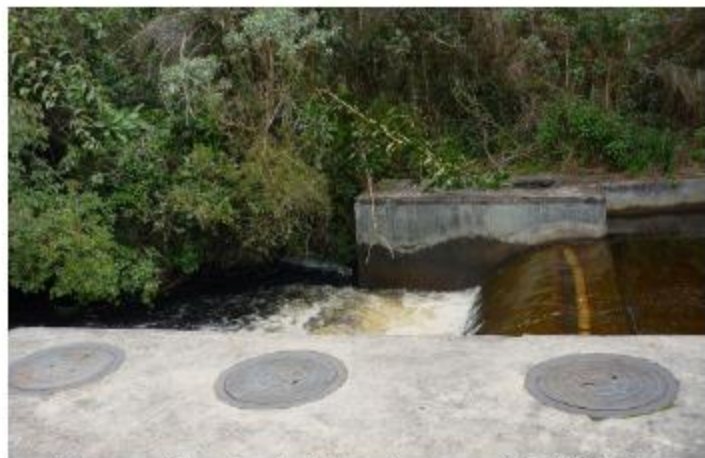
Tanques y caída oxigenadora del acueducto comunitario de Valencia.
