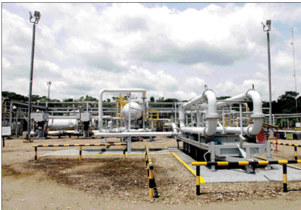
Estación de bombeo Foto: Muro Burzio Municipio de Orellana
