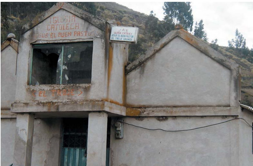
Iglesia en ruinas
